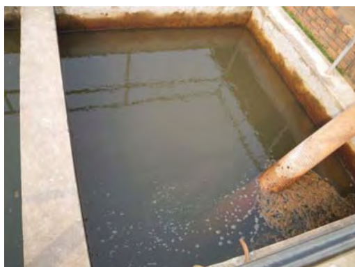
急速ろ過池のバイパス
