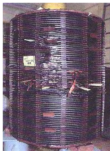
図4 整流器用変圧器の雷被害
