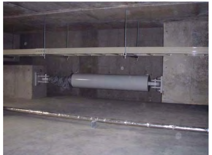
写真-4. オイルダンパー
