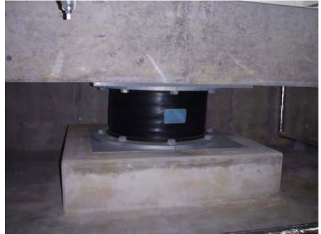
写真-3. 積層ゴム
