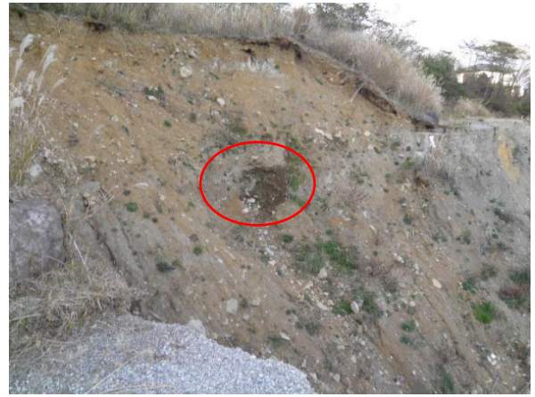
写真 3.5 滑落崖上部の地下水の染み出し
