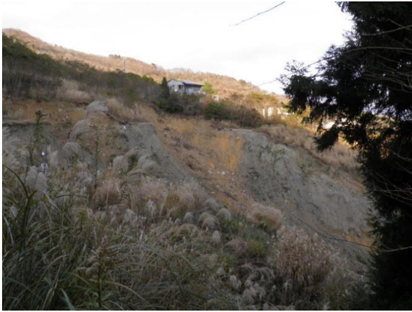
写真 3.4 盛土の滑落崖
