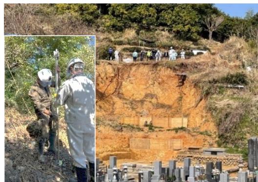
台風 15 号現場調査の様子
