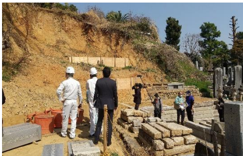
崩壊箇所事例
