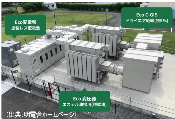
(写真:GX 特高変電所)
